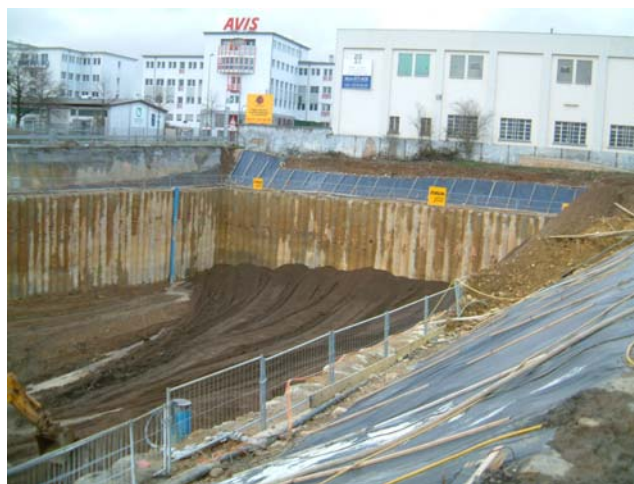
Diese Baugrube gefährdet Häuser und die Straße.
