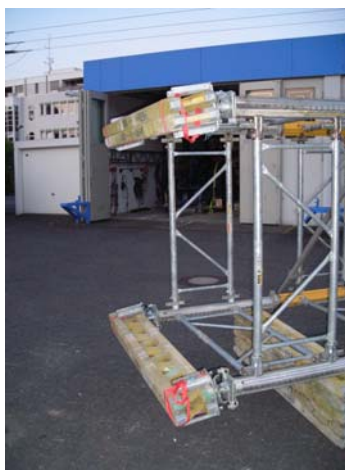
Bild 06 – Vier Kalottenkreuzköpfe (MKK) mit je 2 eingelegten Gitterträgern GT 24
